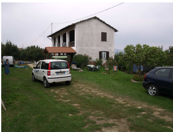
Figura 4.3 - L'abitazione seriamente danneggiata nel corso dell'attivazione del febbraio 1972 era ubicata a fianco dell'edificio visibile in foto (all'epoca stalla) - Foto scattata il 6 settembre 2010
