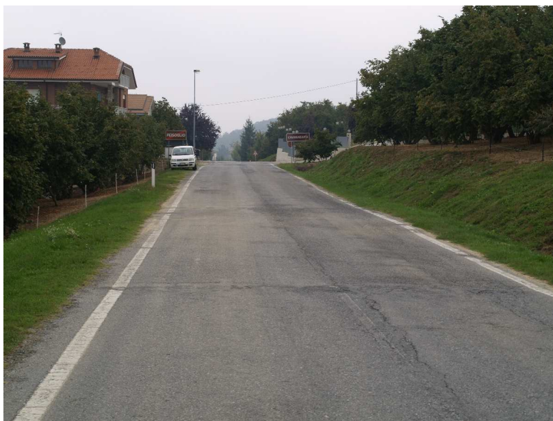
Figura 4.4 - Tratto della strada provinciale danneggiato nel corso dell'attivazione del novembre 1994 - Foto scattata il 6 settembre 2010
