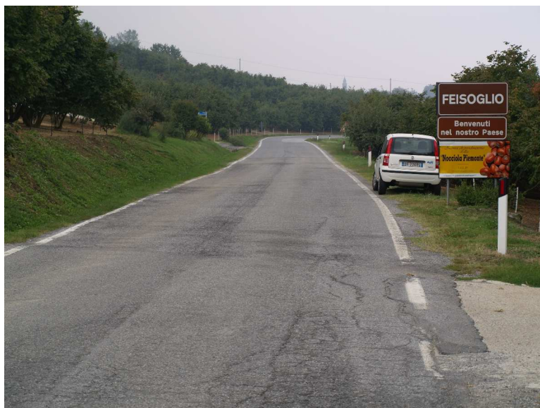
Figura 3.3-Tratto della strada provinciale danneggiato nel corso dell'attivazione del febbraio 1972. Cod danno 1957 - Foto del 06/09/2010
