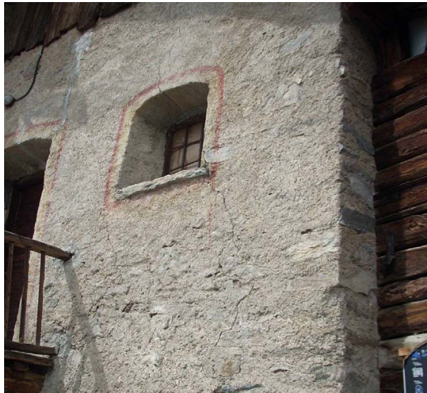
Figura 3.2: Edificio lesionato a Bessen Bas Haute
