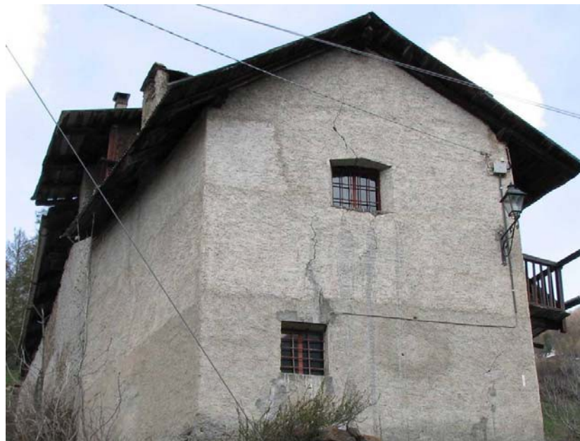
Figura 3.3: edificio lesionato a Bessen Bas
