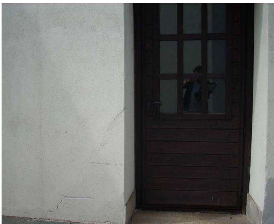
Figura 3.1: Località Grange Sises - edificio con deboli lesioni in parte restaurate
