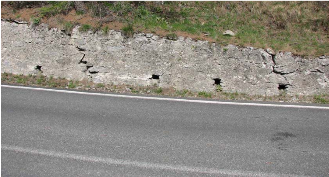
Figura 3.4: Muro di sostegno a lato strada in prossimità di Bessen Bas lesionato
