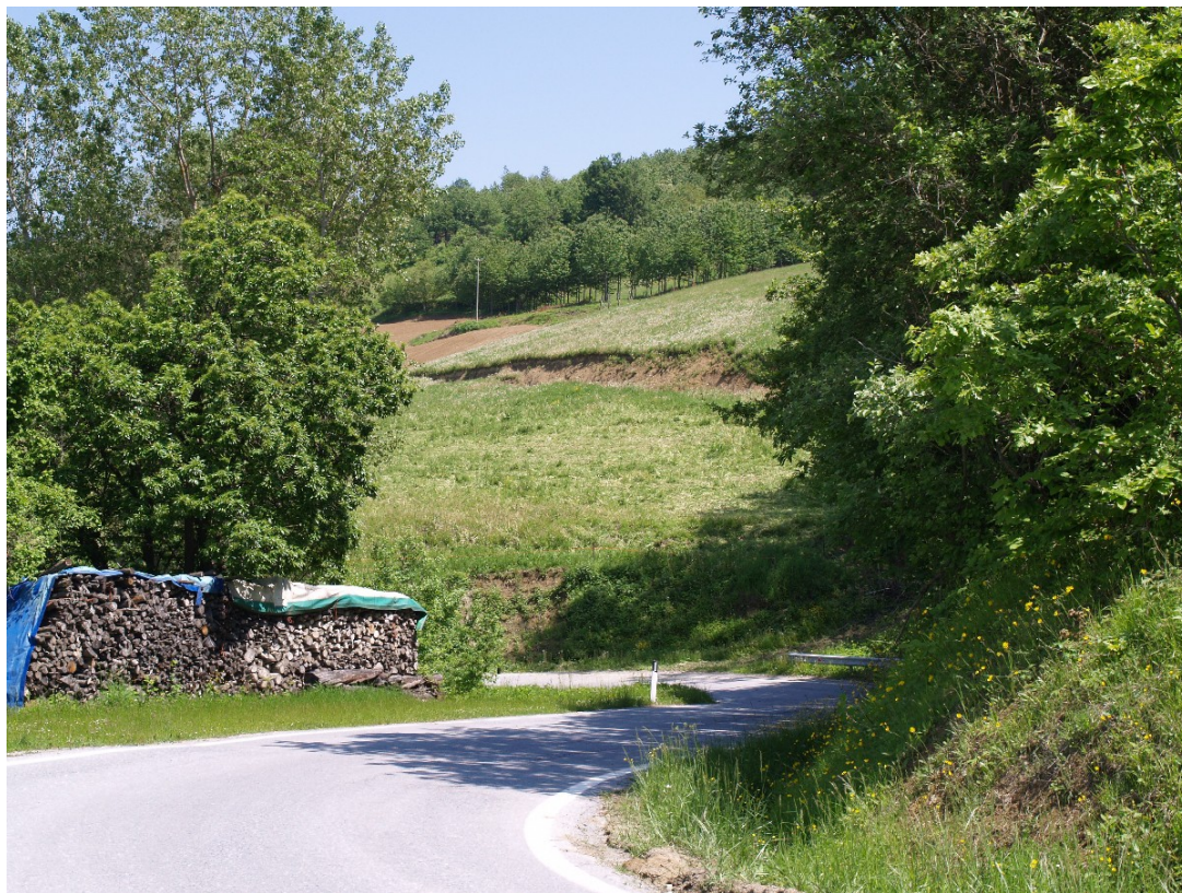
Figura 4.6 - Ripresa di parte della scarpata di frana. Foto del 19/05/2009
