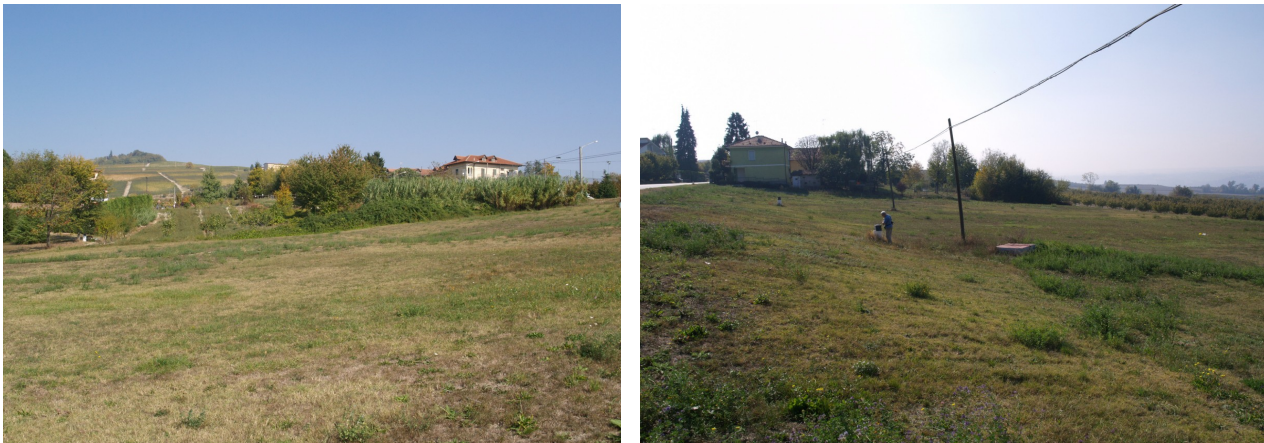
Figura 4.3 - a sinistra, scarpata laterale destra della porzione più attiva del vasto areale in frana. Foto del 13/11/2011. A destra settore sottostante la SP, in prossimità di San Ponzio. Al centro dell'immagine un tombino di drenaggio realizzato dopo l'evento del novembre 1994. Foto del 13/11/2011.
