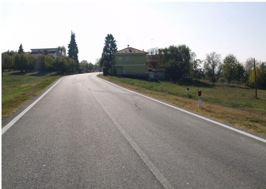
Figura 4.4 - strada provinciale in prossimità di San Ponzio. Sono evidenti le lesioni sul sedime stradale imputabili al movimento franoso. Foto del 13/11/2011.
